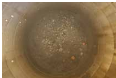
Sickerschacht vor der KALCHER SI - NACHRÜSTUNG
